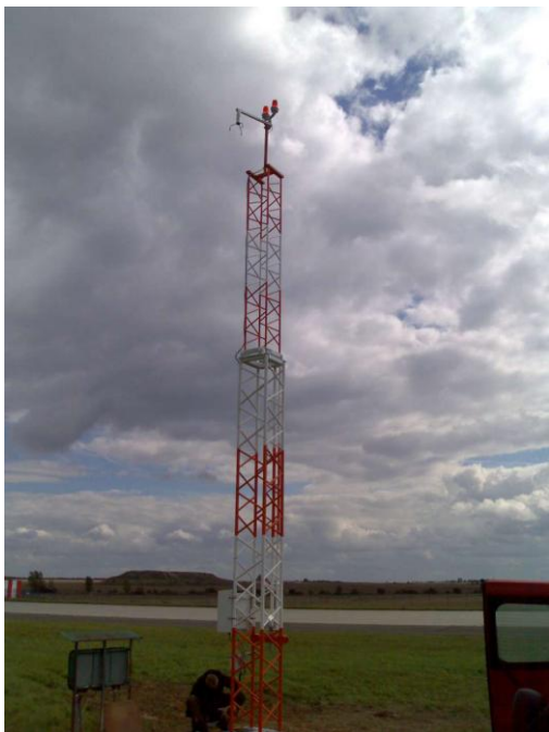
10 m příhradový stožár na TDZ RWY06 na letišti Praha/Ruzyně
